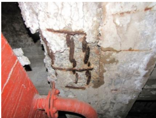
εικ.20 Παρουσίαση αποφλοιωμένης περιοχής οπλισμένου σκυροδέματος όπου αποκαλύπτονται ράβδοι διπλής περιέλιξης
