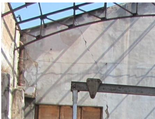
εικ.22 Παρουσίαση υφιστάμενης λιθοδομής με έντονη ρηγματώση σε περιοχή ανοίγματος
